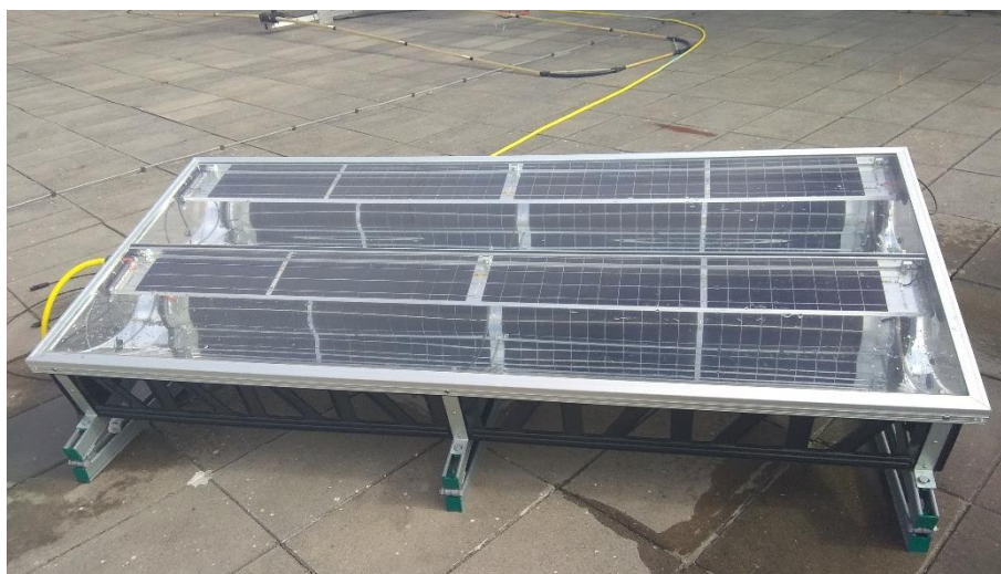
Figura 37 - Instalação térmica do CPVT
