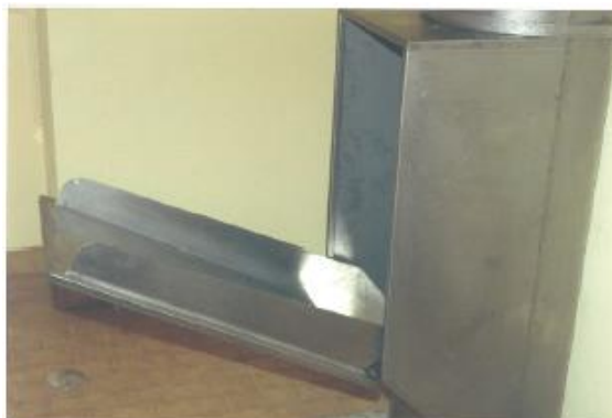
Figura 18 - Estrutura, 2, exemplar de uma conduta de transporte de lixo.
