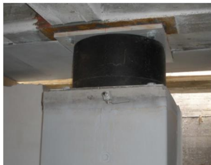
Figura 31- Procedimento de instalação de isoladores em colunas de betão armado (adaptado de Luca Trombetta et al, 2014)
