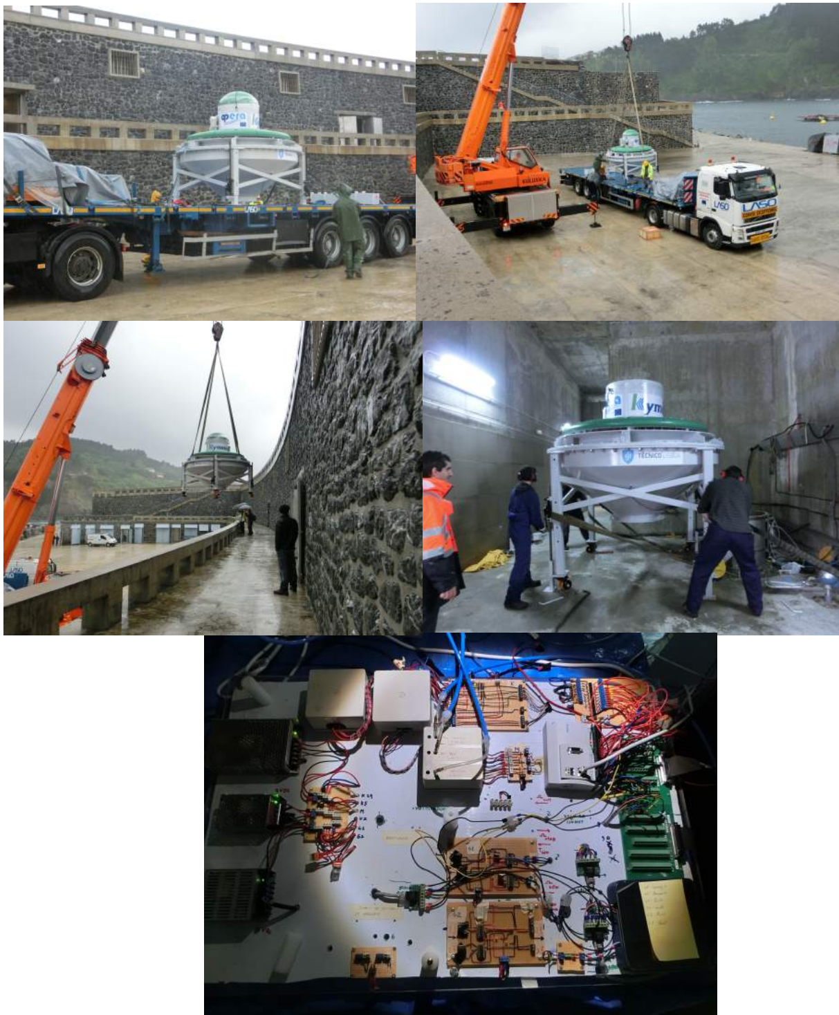
Figura D.5: Chegada do protótipo à Central de Energia das Ondas do Mutriku. Montagem na galeria. Mesa de controlo.
