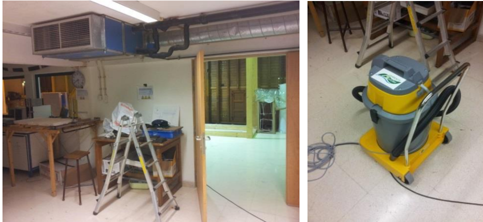
Figura 3.8 - Equipamento objecto de reparação - esquerda; Escada amovível e aspirador de sucção - direita
