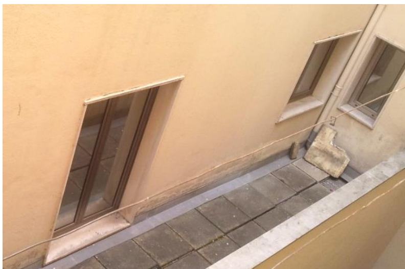
Figura 5.3 - Presença de elementos soltos e colonização biológica
