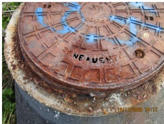
Figura 5.4 - Exemplos de câmaras de visita com a tampa em elevado estado de corrosão e aro partido.
