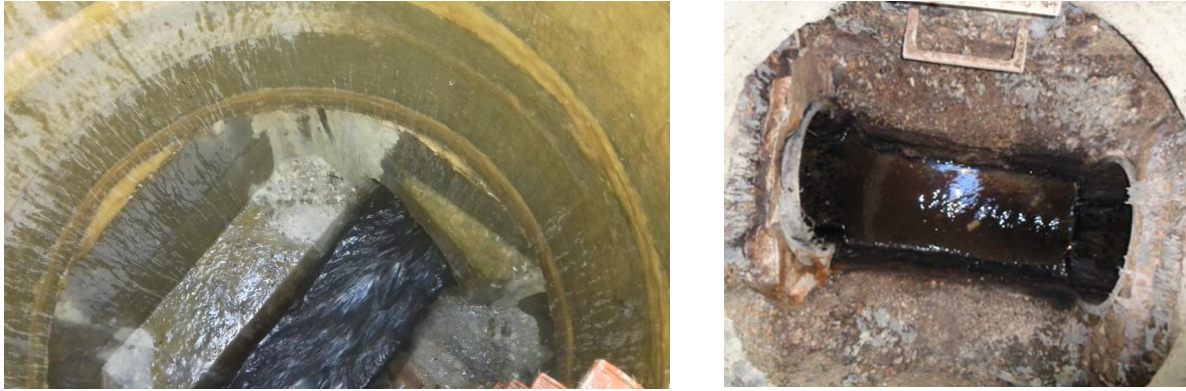
Figura 5.5 - Exemplos de câmaras de visita com infiltrações nas juntas (Esq.) e com soleira com um grau elevado de corrosão (Dir.).
