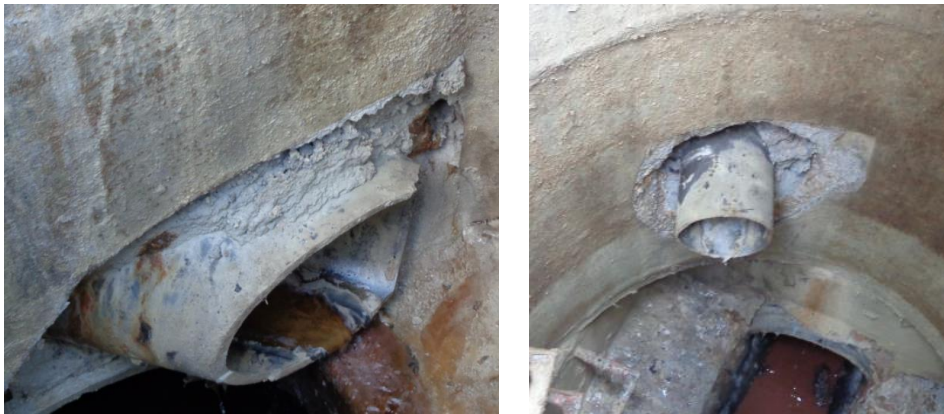
Figura 5.6 - Exemplos de ramais mal selados.
