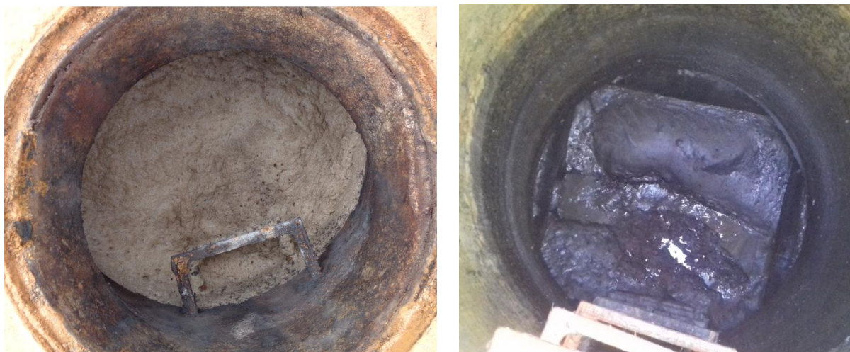
Figura 5.7 - Exemplos de câmaras onde se observaram espumas (Esq.) e acumulação de sedimentos (Dir.).
