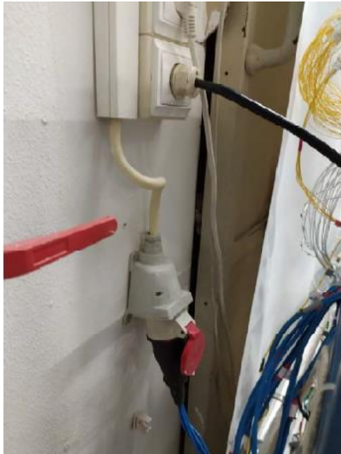
Fig. 3.15 – Tomadas e cabos da bomba e VOLTEQ.
