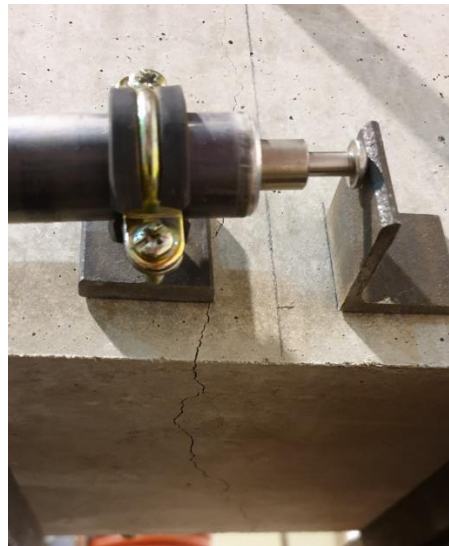
Figura 3.8 – Fenda visível numa viga ensaiada
