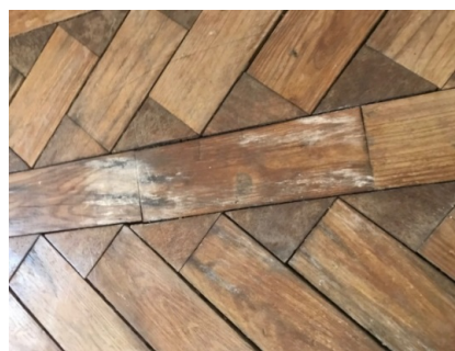
Figura 2.12: Presença de fungos (cor branca)
