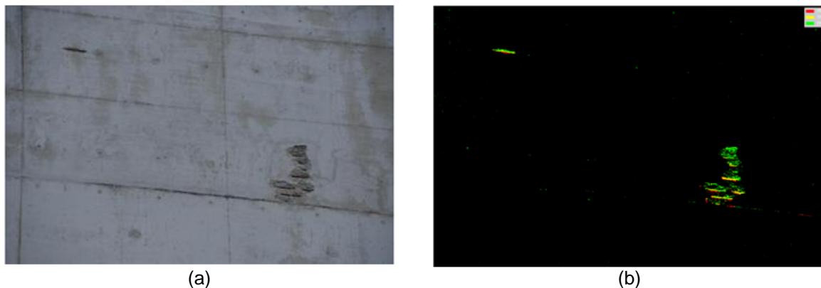
Figura 41 - Resultado da aplicação do método de deteção de Armadura à Vista no painel 33: a) fotografia original do painel 33 e b) resultado do método.
