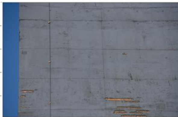
Figura 21 – Identificação da anomalia Armadura à vista do painel 13, observável através da sobreposição da informação obtida através do processamento do programa SC-Anom ;
