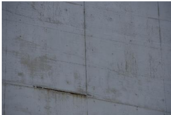
Armadura à Vista
