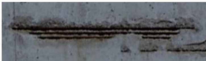
Figura 30 - Armadura à Vista e respetivos produtos de corrosão;
