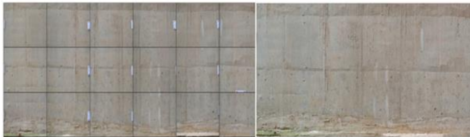
Figura 5 - Secção B, estudada por fotogrametria da barragem de Itaipu, Brasil (à esquerda o painel dividido por fotografias obtidas, à direita, o painel orto-retificado) (Valença e Júlio, 2018);
