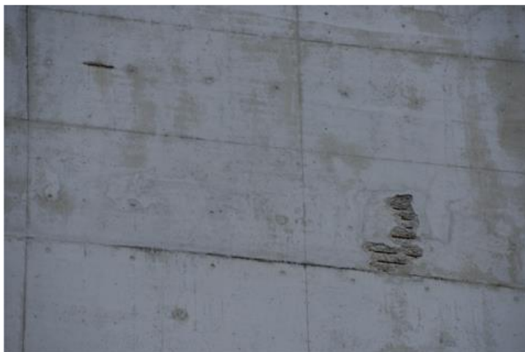
Armadura à Vista
