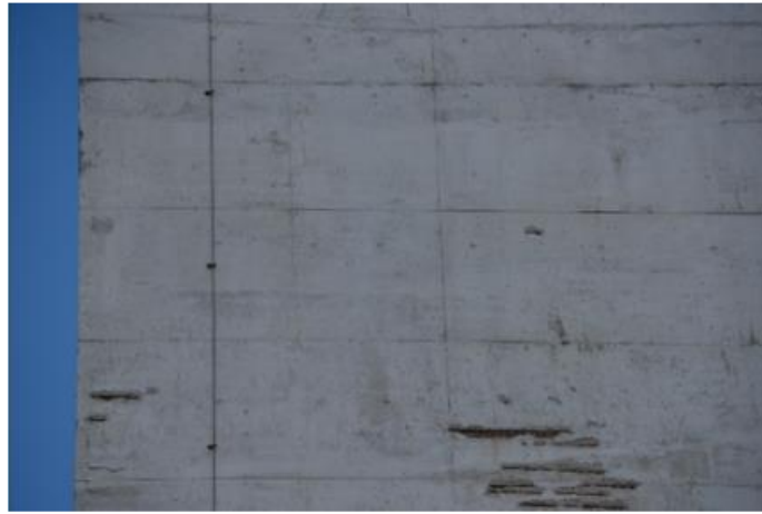
Armadura à Vista
