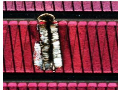
(b) Queimadura provocada por curto-circuito nas células.
