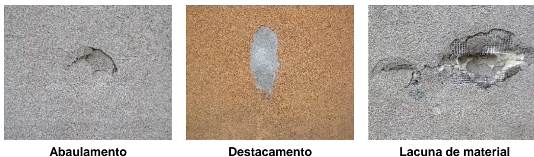
Figura 2.6 - Exemplos ilustrativos de anomalias de perda de aderência
