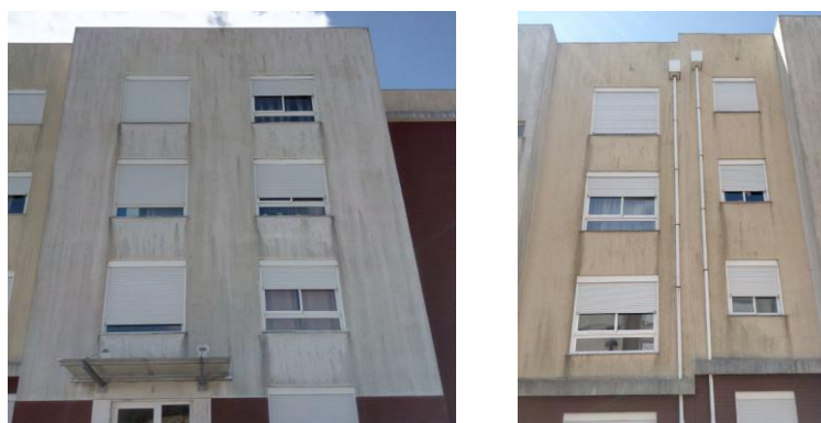
Figura 3.35 - Aspeto degradado das fachadas excluídas da amostra, no Empreendimento Alto da Mira, na Amadora
