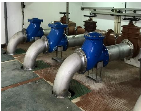
Figura 39 - Bombas Estação Elevatória
