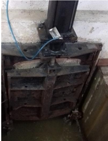
Figura 41 - Válvula mural de entrada com principais pontos de intervenção de manutenção
