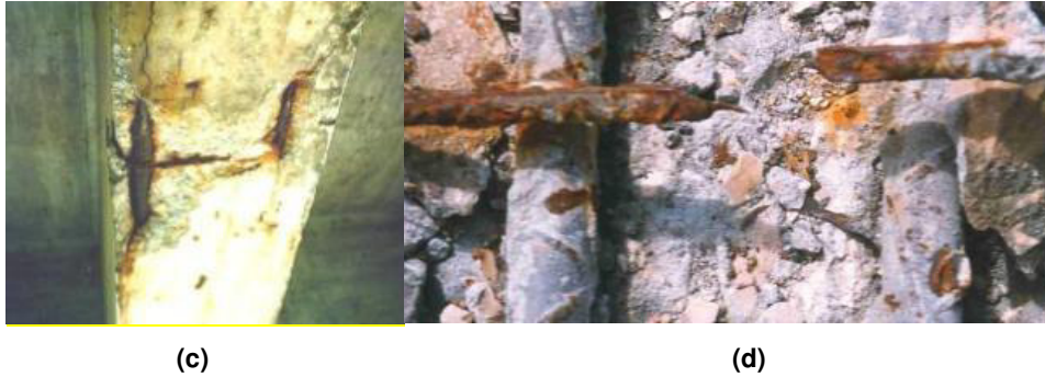
Figura 2.5 – (a) Aparecimento de fendas em pilar (Costa, 2014). (b) Delaminação do betão de recobrimento (Costa, 2014). (c) Aparecimento das armaduras na zona inferior da viga de betão (Costa, 2014). (d) Corrosão por acção dos cloretos (Costa, 2014).
