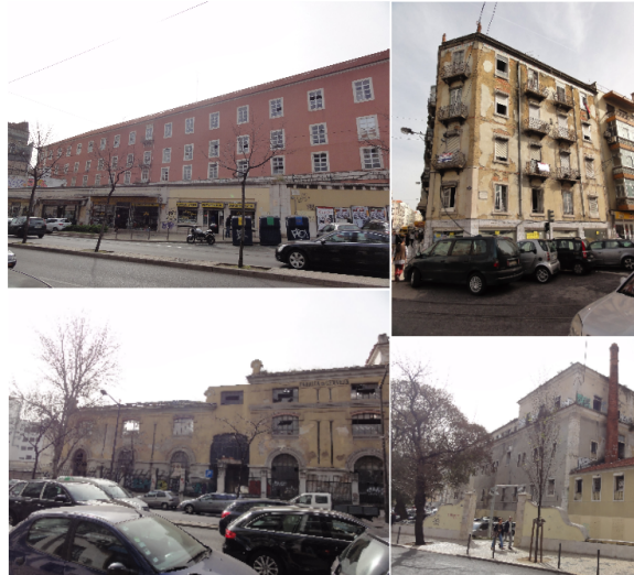
Figura 4.2 – Fotografias de prédios existentes na Av. Almirante Reis em avançado estado de degradação.
