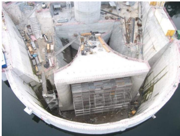
Figura 2.3: Fotografia de ensecadeira de betão em arco adotada para a realização da tomada de água do Reforço de Potência de Venda Nova III (adaptada de http://www.ruivaes.com/2012/11/venda-nova-iii-fotos-da-obra.html - 17:20h em 24/02/2015).
