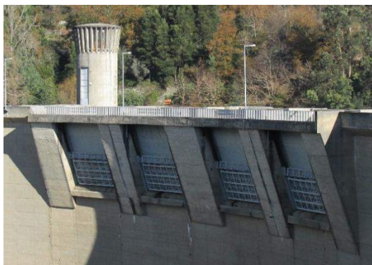
Figura 3.3: Pormenor do descarregador de cheias, constituído por quatro vãos, da barragem da Caniçada.
