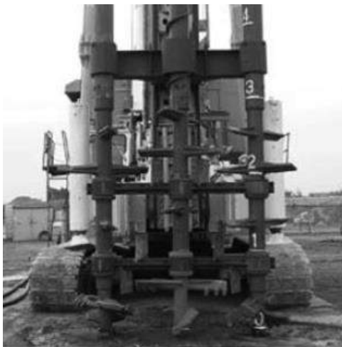
Figura 5.36: : Equipamento utilizado na técnica DSM constituído por três varas de furação com ferramentas de corte e de homogeneização (adaptada de Kitazume, M. & Terashi, M. (2013)).
