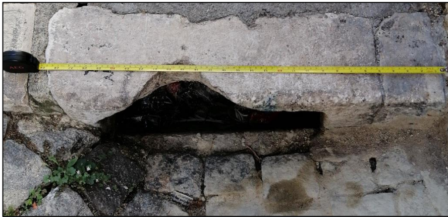
Figura 5.7 - Exemplo de estado de conservação de sarjeta encontrada no local de estudo
