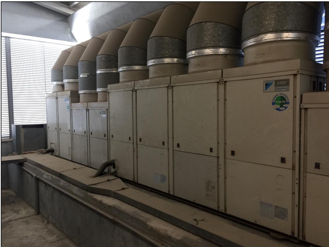
Figura 17: Sistema de climatização VRV
