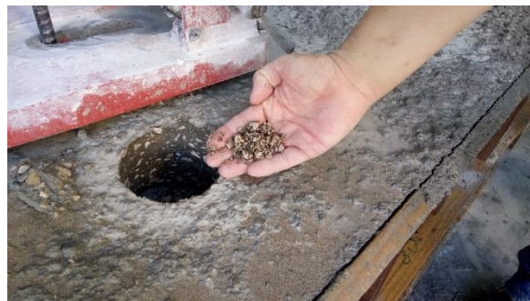
Figura 4.6 - Material desagregado retirado da interface entre BP e betão de substrato
