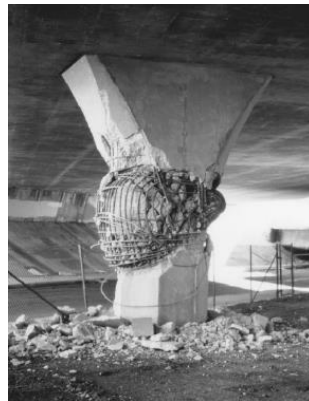
Figura 2.2. Rotura de pilar curto em San Fernando (1971), [1]
