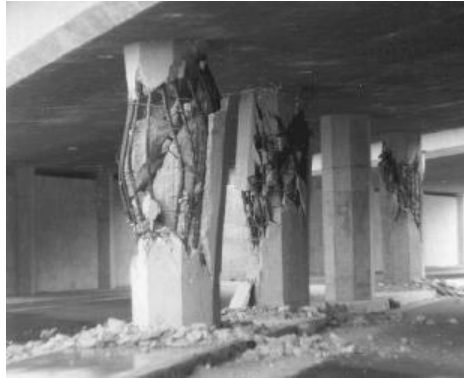
Figura 2.1. Colapso por insuficiente resistência ao esforço transversal em Kobe (1955), [1]
