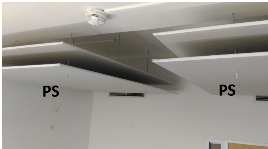
Figura 34- Placas de PCM suspensas no teto
