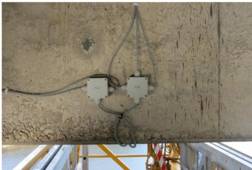
Figura 3.6: Caixas de derivação de termómetros
