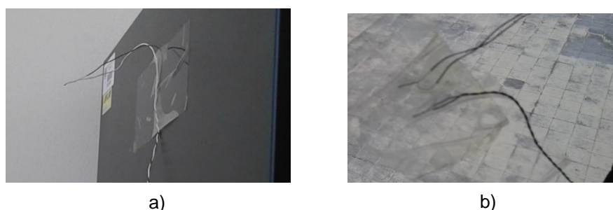
Figura 4.8 - Termopares utilizados na campanha experimental: a) termopares para medição da temperatura ambiente interior; b) medição da temperatura superficial interior e exterior.
