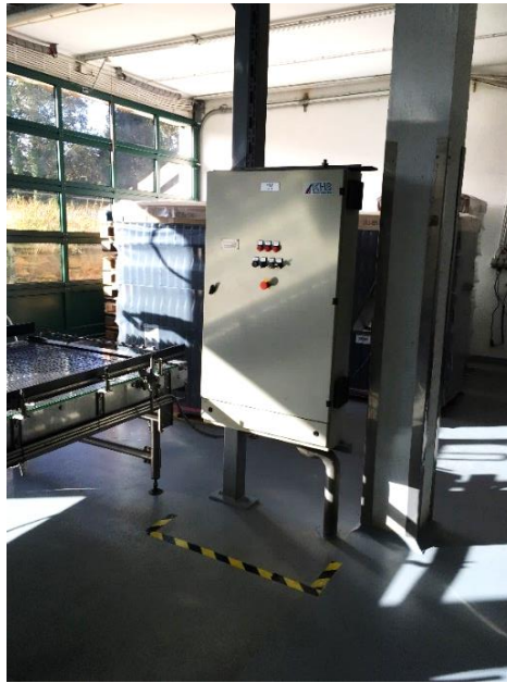
Figura 12 – Marcação do chão em frente ao quadro elétrico
