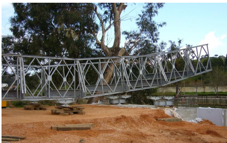
Figura 18 - Pormenor do nariz de lançamento em consola. Adaptado de Companhia de Pontes (2011)
