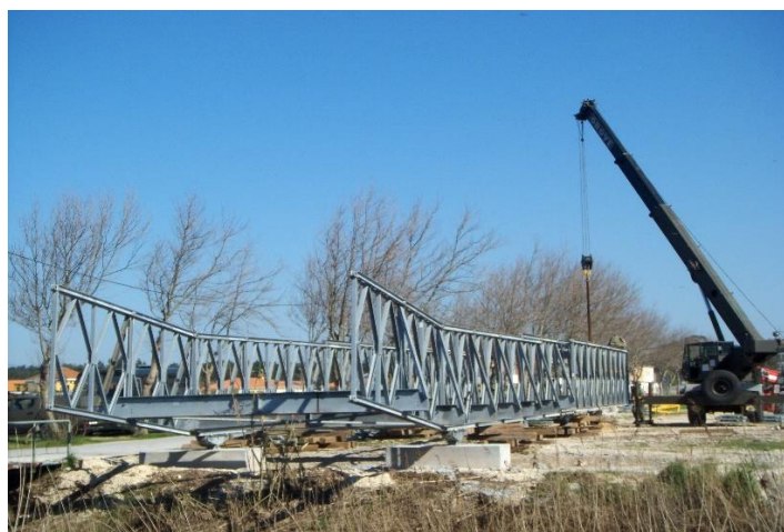
Figura 16 - Montagem com recurso a lançamento incremental, foto tirada pela Companhia de Pontes, do RE1, em Mira
