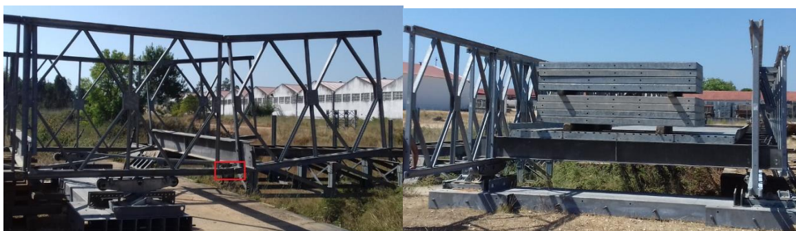
Figura 60 – Ligação de Lançamento adotada no painel de extremidade (à esquerda) e contrapeso colocado na margem de lançamento (à direita). Fotografias tiradas em Tancos dia 10/07/2020
