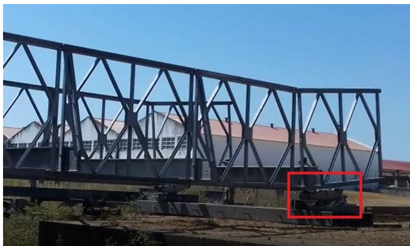
Figura 68 - Primeiro contacto do nariz de lançamento com os roletes da margem oposta, fotografia tirada em Tancos dia 10/07/2020
