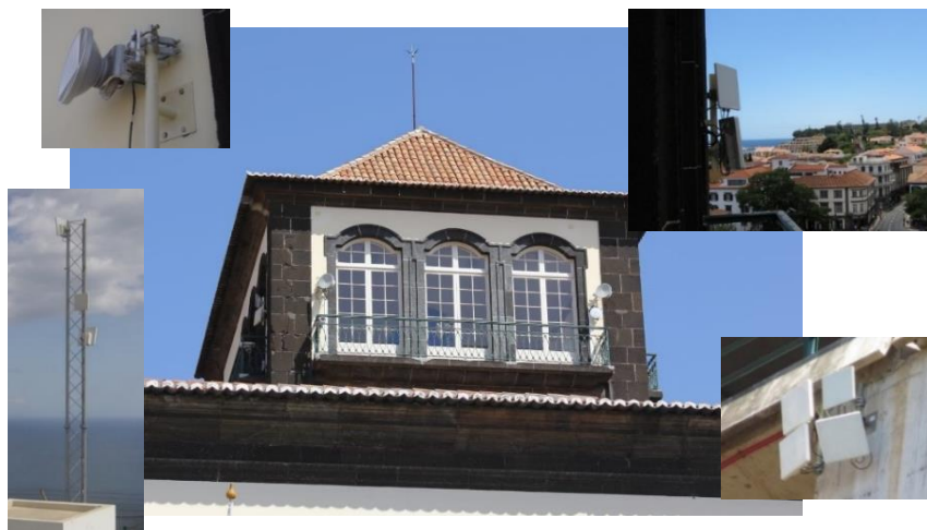
Figura 4.1 – Instalação de antenas da rede da CMF.
