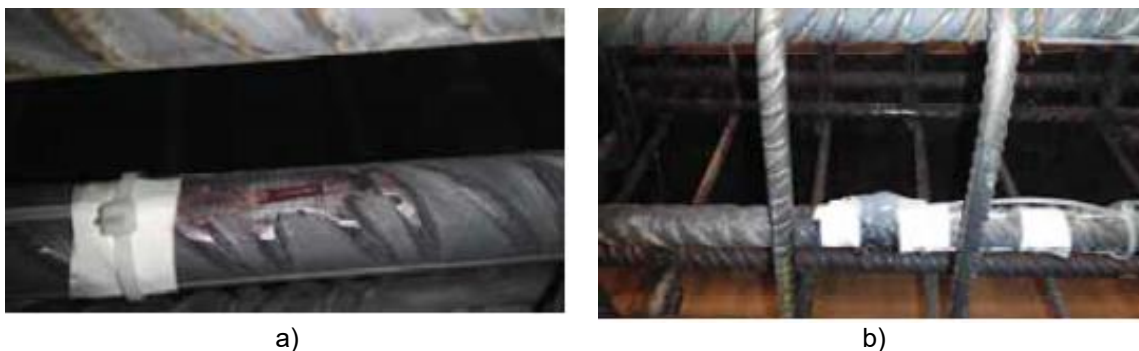
Figura 3.11 - Colocação dos extensômetros nos varões a) aplicação de cola, b) aplicação de silicone para proteção durante a betonagem (adaptado de Robust Brick (2016)).
