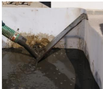
Figura 15 - Carregamento do leito de secagem de lamas.
