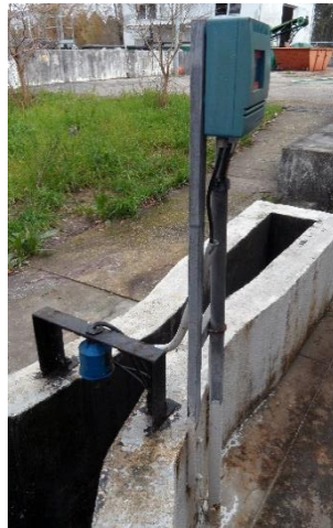
Figura 35 – Caudalímetro instalado na obra de entrada da ETAR da Área de Serviço da BP da Mealhada.
