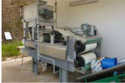
Figura 30 – Equipamento de filtros banda (Águas Públicas do Alentejo, s.d.).
