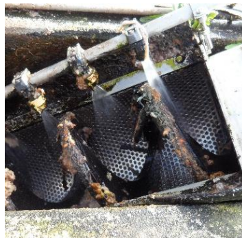
Figura 12 – Pormenor de um tamisador, com sistema de limpeza de gradados, ETAR da Área de Serviço da BP de Santarém.
