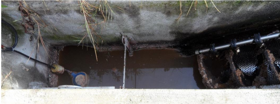
Figura 13 – Boia de nível na obra de entrada que faz acionar o tamisador na ETAR da Área de Serviço da BP de Santarém.
