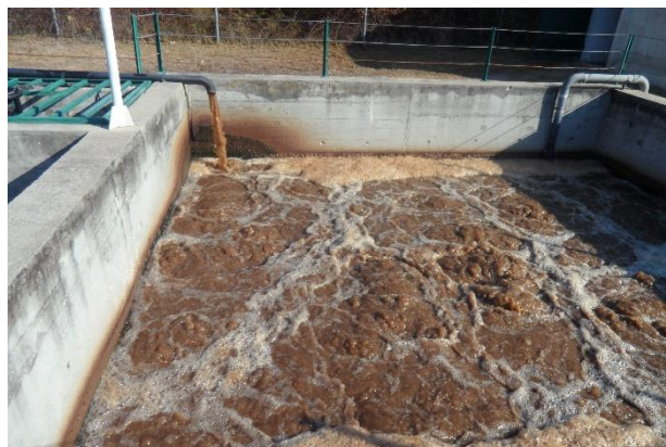
Figura 19 – Tanque de arejamento com recirculação de lamas, ETAR da Área de Serviço da BP de Santarém.
