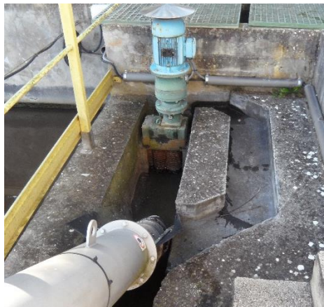
Figura 14 – By-pass entre a entrada do afluente até depois do tamisador na ETAR do hospital Dr. José Maria Antunes Júnior em Torres Vedras.
