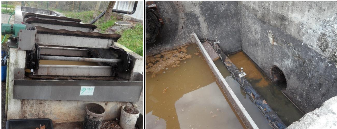
Figura 15 – Desengordurador mecânico da ETAR da Área de Serviço da BP da Mealhada, com o pormenor da saída do efluente do lado esquerdo.
