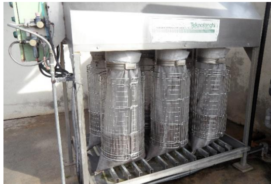
Figura 28 – Sistema de desidratação de lamas por sacos filtrantes (unidade de 6 sacos), ETAR da Área de Serviço da BP de Santarém.
