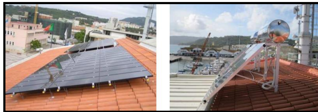
Figura 44 – Painéis fotovoltaicos na cobertura do edifício sede da APSS. Fonte: (APSS, 2011)
