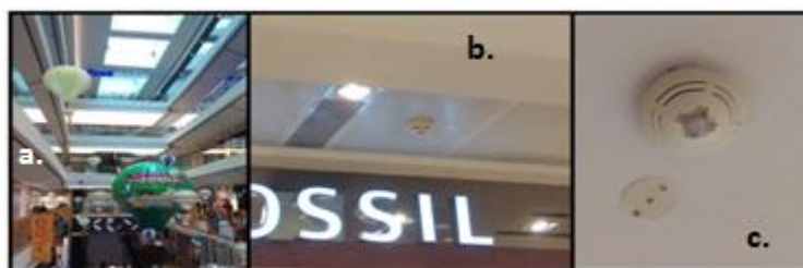
Figura 28 – 313@Somerset - Átrio principal (a.), sistema de iluminação dos corredores (b.) e sensor de ocupação (c.) que são vários distribuídos pelo centro comercial. Fonte: Autora, Junho 2015.
