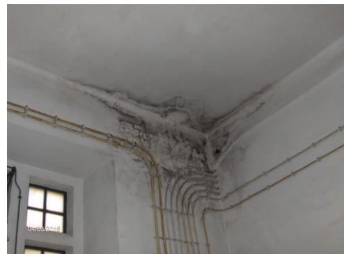
Figura 17 - Manchas de humidade visíveis ao nível do rés-do-chão.
