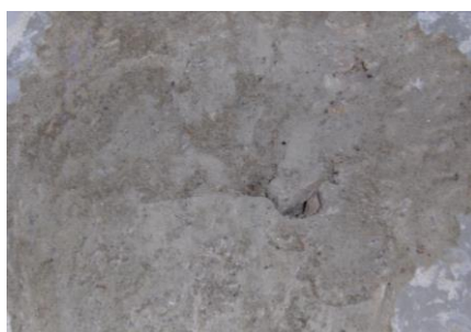
Figura 26 - Superfície de um pilar após remoção do reboco. Detalhe da presença de vazios.
