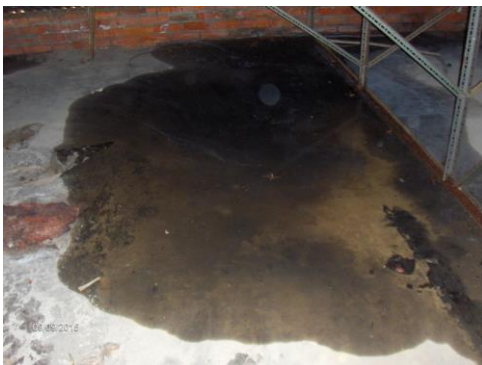
Figura 16 - Acumulação de águas pluviais na laje de cobertura.
