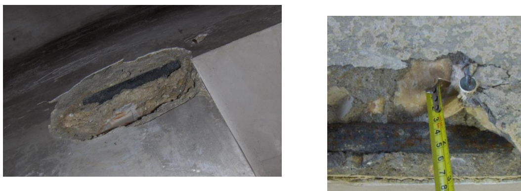
Figura 29- Armaduras de viga à vista.
