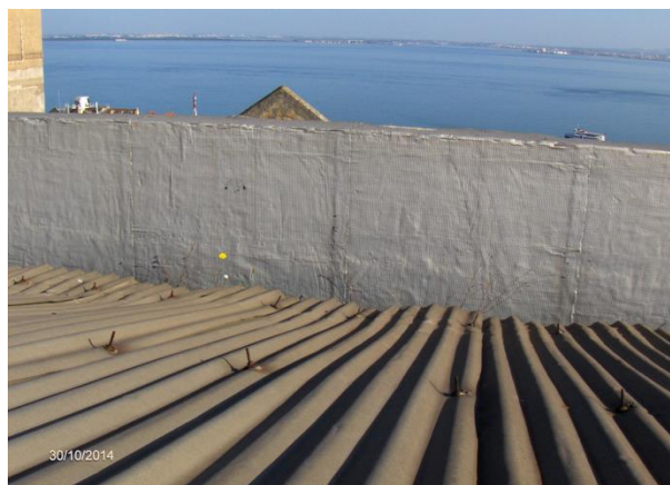
Figura 13 - Pormenor da platibanda.
