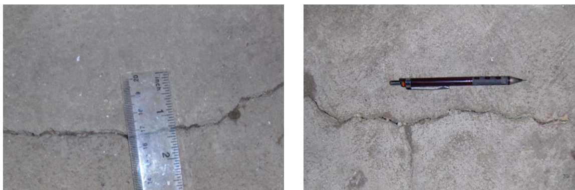
Figura 19 - Fendas visíveis na face superior da laje de cobertura.
